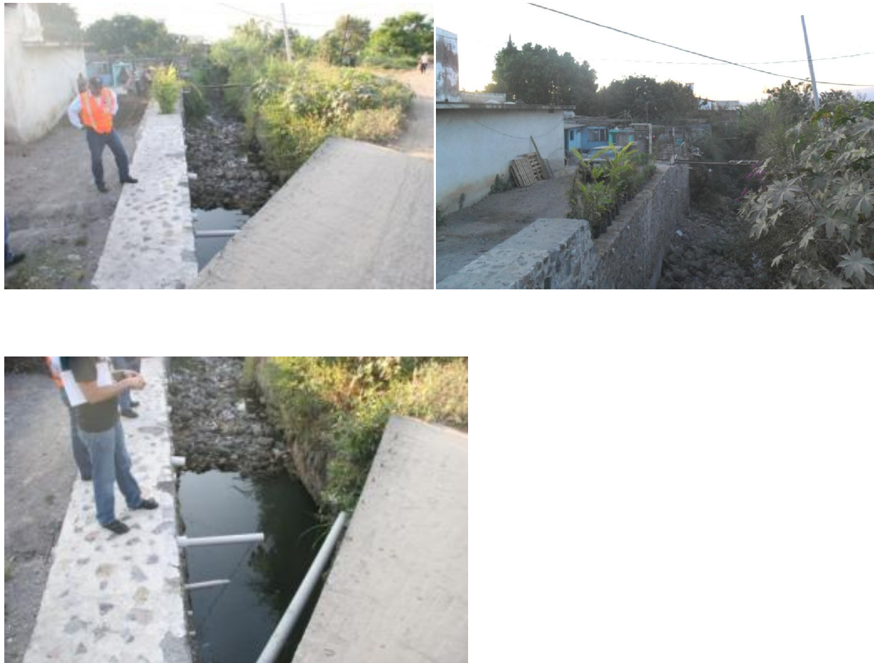
Figura 41. Canal (arroyo Xochimelcancingo) de alto poder de socavación en las calles 3 de noviembre y Camino a la Antigua Vía (o del FC Interoceánico)
