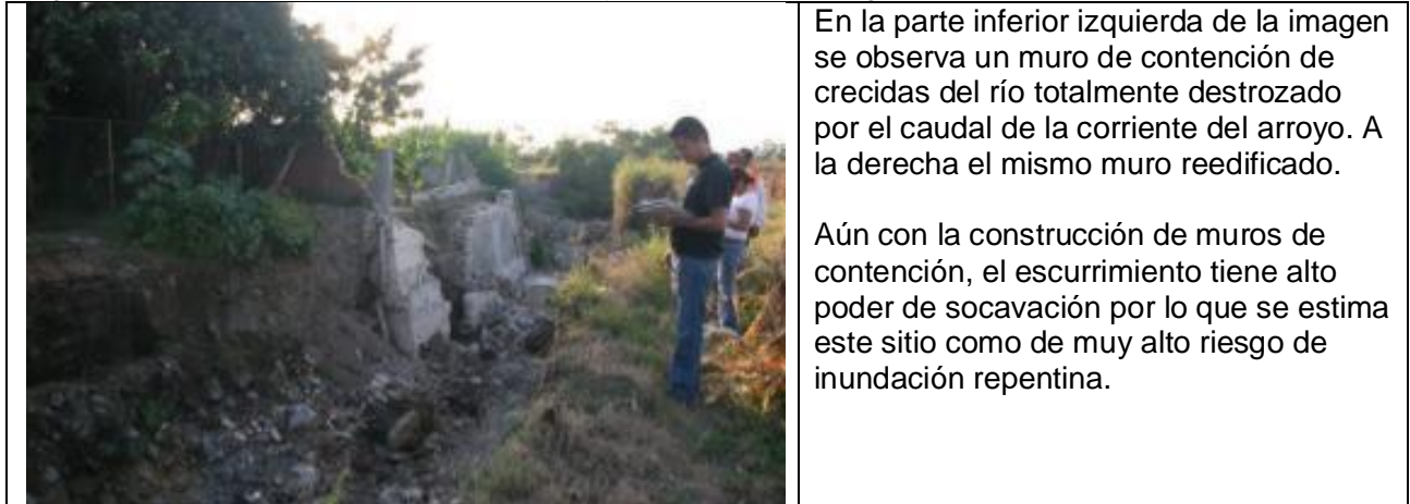
Figura 44. Viviendas afectadas por el Arroyo Xochimelcancingo.
