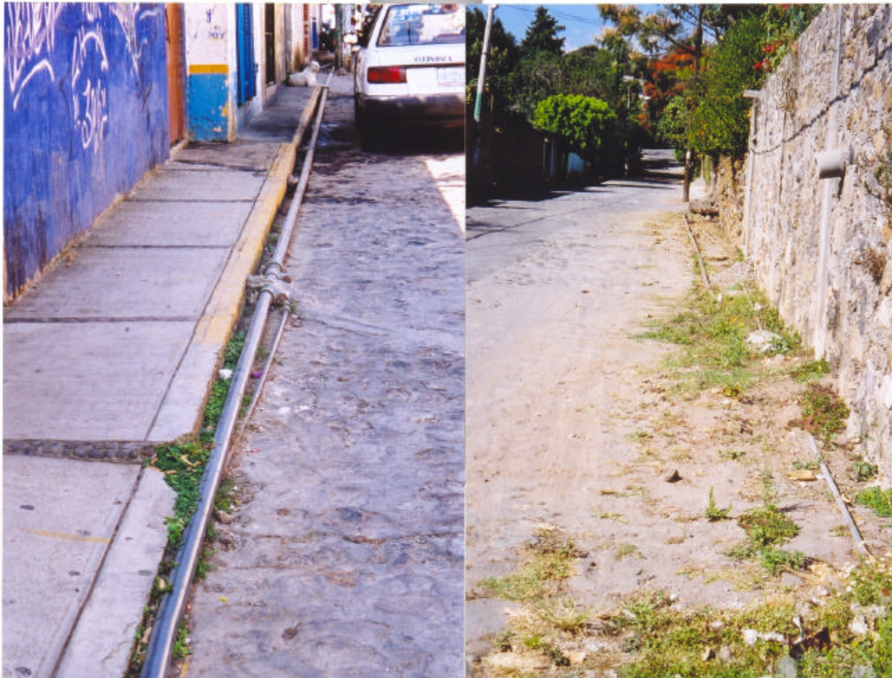
Línea superficial de agua potable, izquierda calle Francisco Villa y derecha calle Emiliano Zapata (foto 15 y 16)
