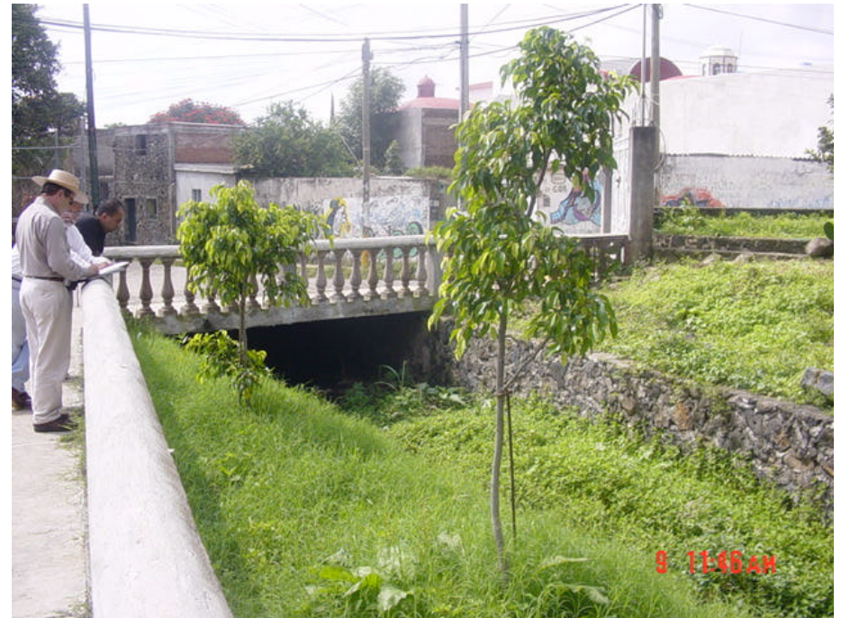
Vista de la barranquilla calle Francisco I. Madero y calle Galeana en donde se aprecia la contaminación por desechos sólidos (fotos 15 y 16))
